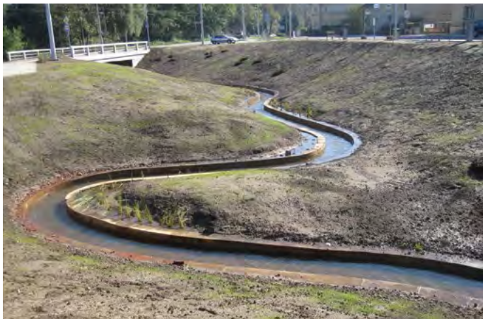
Obr. 2. Úprava potoka v obci, která zvlněním kynety imituje revitalizaci a dost možná byla prezentována/placena jako přírodě blízká protipovodňová úprava. Betonovými tvarovkami vymezený obdélníkový průřez kynety však je přírodě vzdálený. Aby se mohlo hovořit o skutečně přírodě blízké úpravě, bude nutné kynetu předělat. Nepochopení příležitosti, nepochopení základních principů
