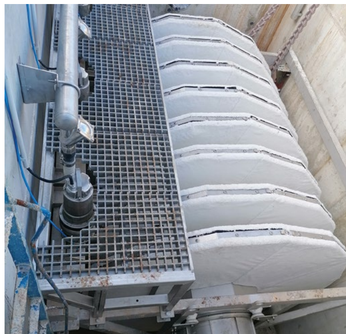
Obr. 3. Pile Cloth filtr „ORSO“ – stav po instalaci před napuštěním nádrže, ČOV, Španělsko
