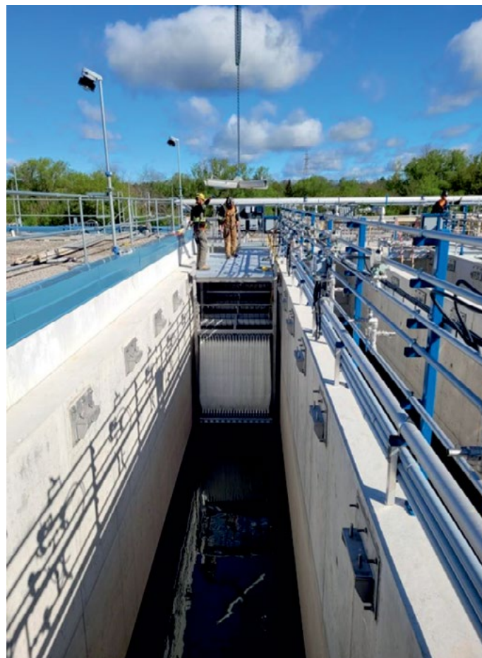
Obr. 5. Instalace kazet ZeeLung ve společnosti Hespeler (Ontario, Kanada)
