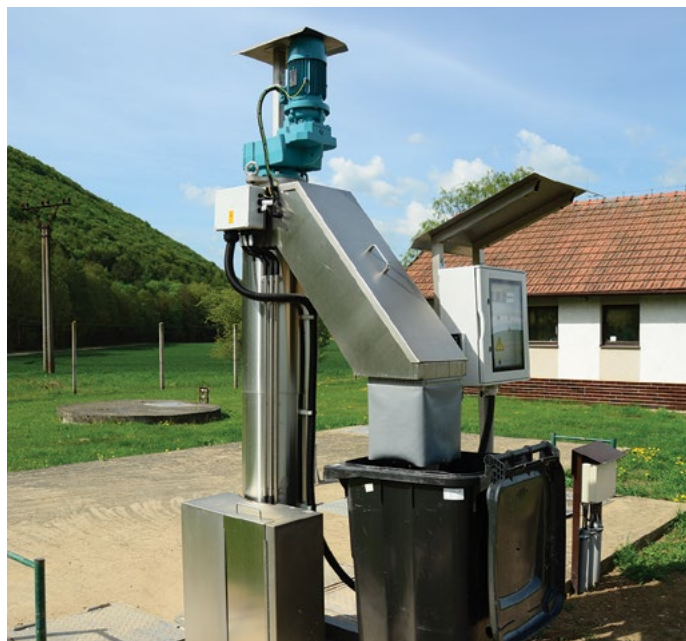
Obr. 1. Prutové česle kolmé, ČOV, Česká republika
