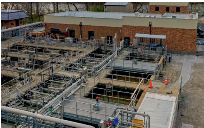
Obr. 4. Letecký pohled na ČOV Yorkville, kde je ZeeLung MABR v provozu od roku 2017 (a). Detailní pohled na technologii ZeeLung MABR se zahušťováním kalu v pozadí (b)
