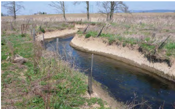
Jaro 2009: Koryto Lukovského potoka setrvává ve značném zahloubení, jeho stav se jen zvolna zlepšuje sesouváním břehů. V korytě ani podél něj se neuchycuje dřevinná vegetace
