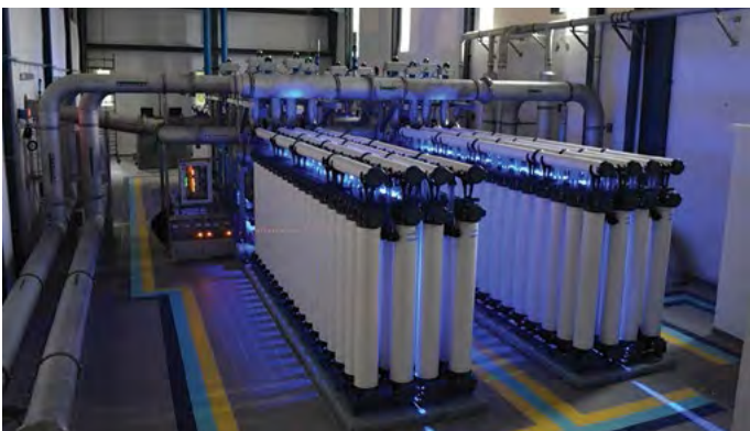
Úpravna vody Březová
