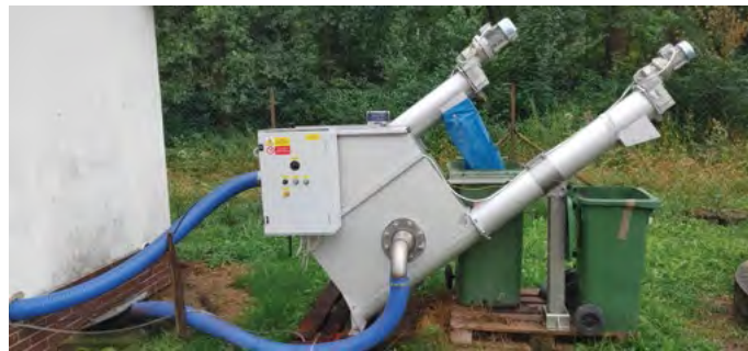
Obr. 3. Kompaktní zařízení HB02 na ČOV Bořitov
