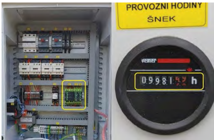
Obr. 2. Řídicí rozvaděč stroje
