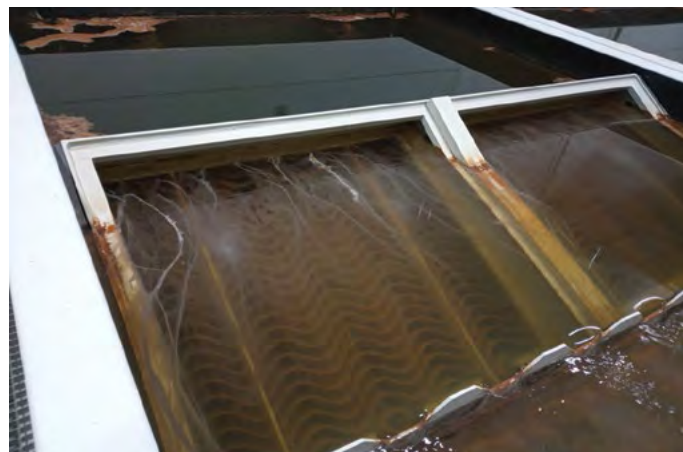
Obr. 1. Nárasty kolónií železítých baktérií ( Siderocapsa sp. ) v lamelových usadzovacích nádržiach
